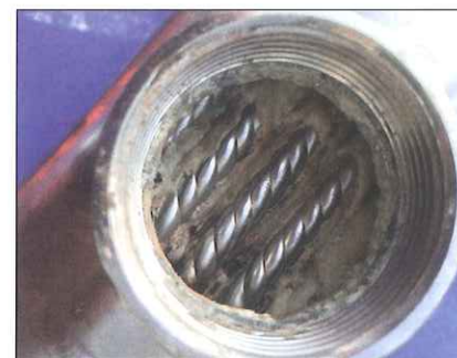
Fot.1 Zdjęcie wlotu do wymiennika przepływowego zanieczyszczonego osadami węglanu wapnia
