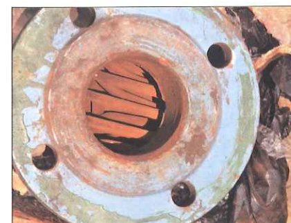
Fot. 6 Wymiennik przepływowy (wlot) typu JAD 6/50 z instalacji c.w. zanieczyszczony osadem mieszanym, związków wapnia i żelaza
