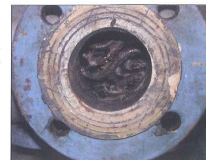
Fot.2 Zdjęcie wlotu do wymiennika JAD 6/50 zanieczyszczonego osadami głównie związków żelaza
