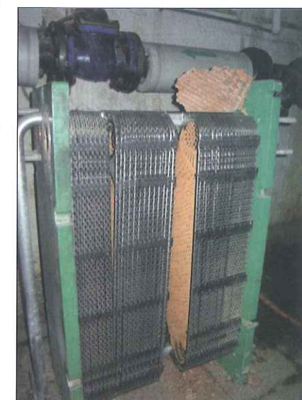
Fot.3 Wymiennik płytowy rozbieralny zanieczyszczony osadami głównie węglanu wapnia
